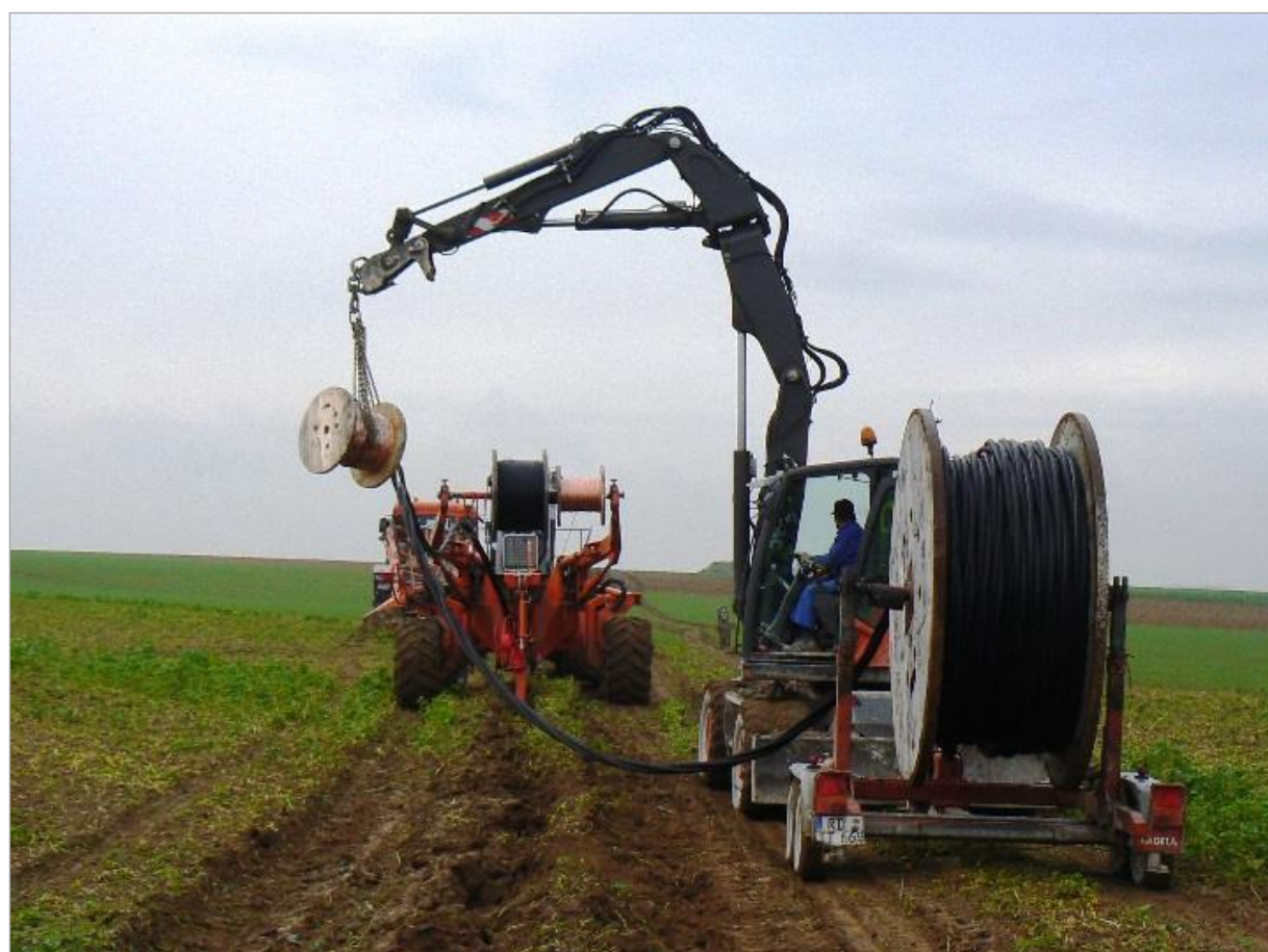
Figure 3.12 : Pose d'un câble HTA à 1,20 m avec la méthode du soc tracté
